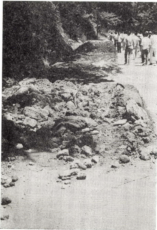
台風による崖くずれ、道路寸断のため土砂除去の箇所。
